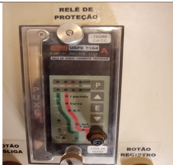
Relé de Proteção
