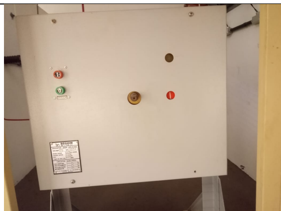
Disjuntor Media Tensão
