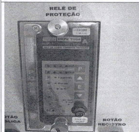
Relé de Proteção
