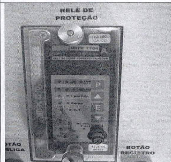
Relé de Proteção
