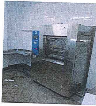
Figura 9 – Termodesinfectora no seu devido local.
