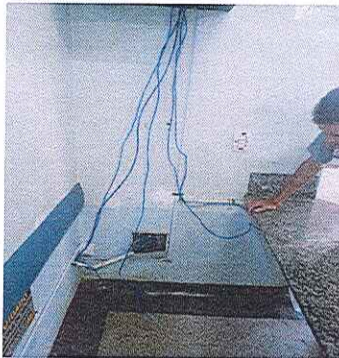
Figura 4 – Fiação exposta no posto 1.
